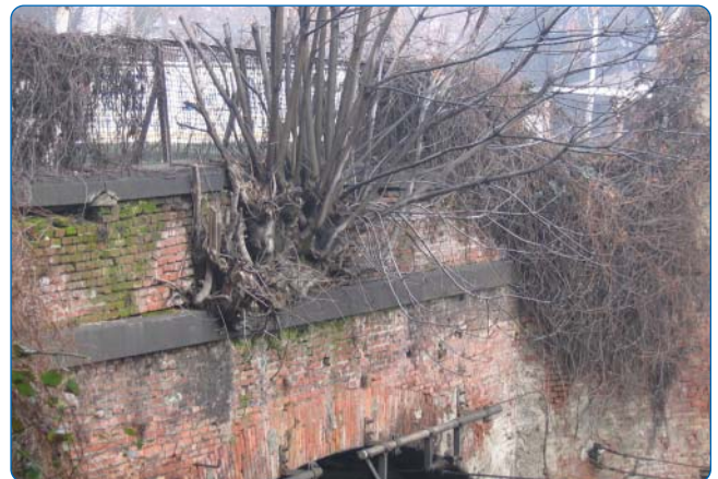
Fig. 8 - Portale degradato a causa della presenza di una pianta di "fico"
